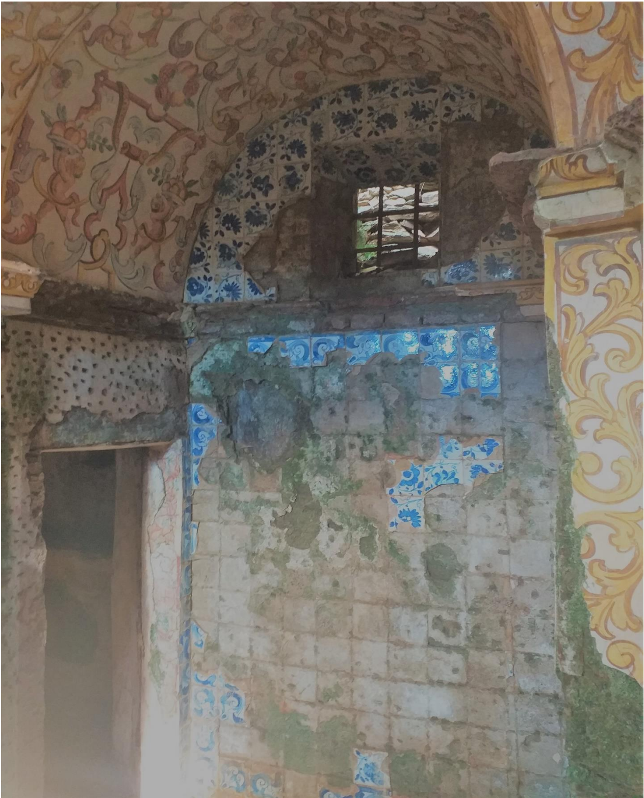
Transepto da Ermida de Nossa Senhora dos Remédios, com os sinais de degradação e vandalismo e nível do revestimento azulejar
